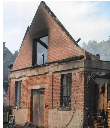
Abbildung 15_Giebelwand nach Brand, FF Gensingen
