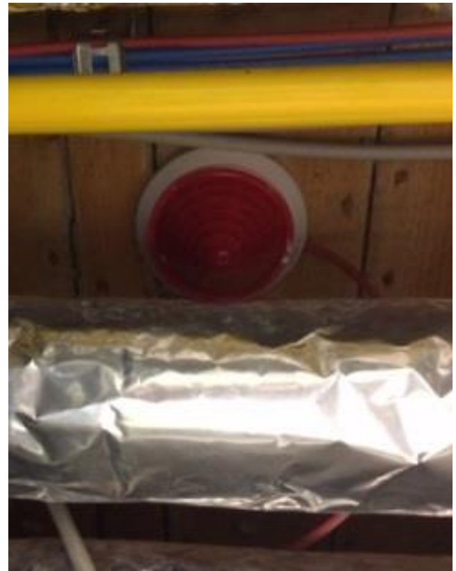
Abb. 22: Zwischendeckenmelder mit Staubschutzkappe während Bauarbeiten
